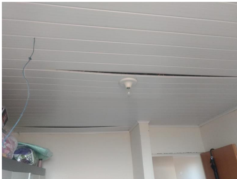
FIGURA 4 – Problemas com o forro.
