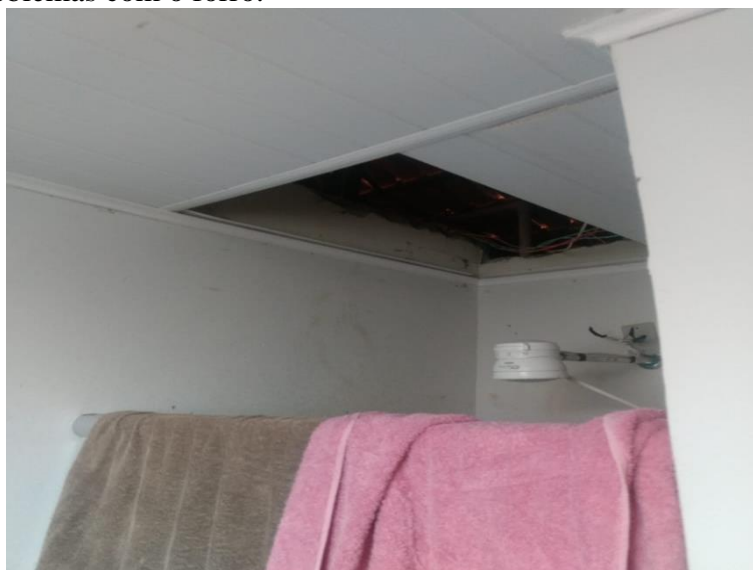
FIGURA 5 – Problemas com o forro.
