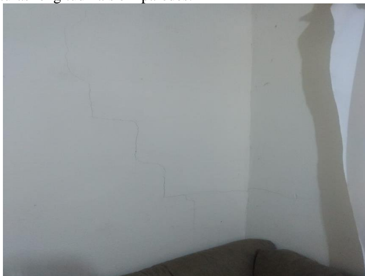
FIGURA 7 – Roturas longitudinais em paredes.
