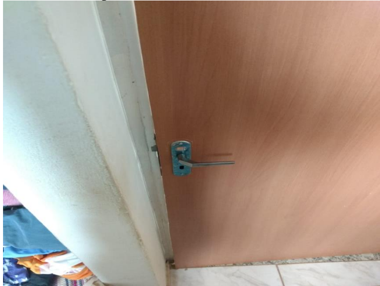
FIGURA 3 – Problemas com as portas.
