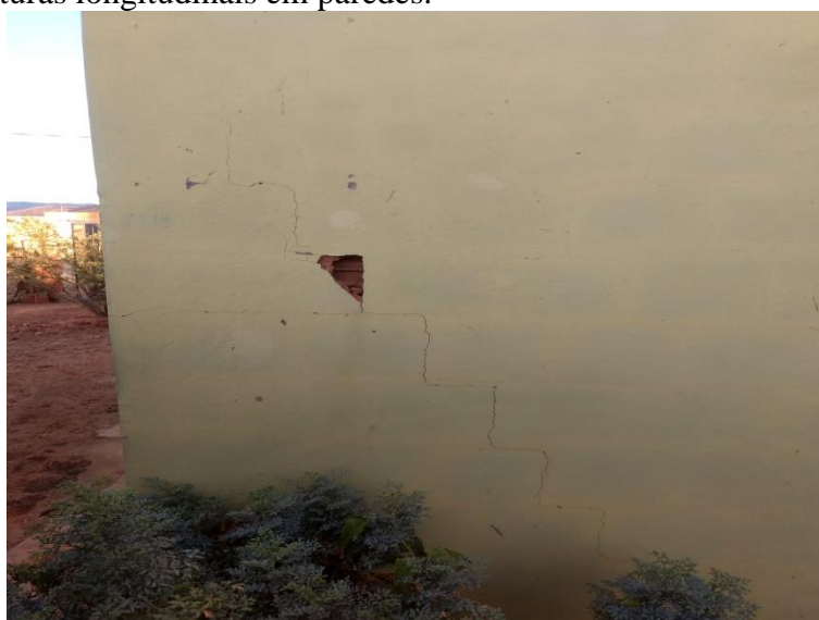
FIGURA 8 – Roturas longitudinais em paredes.
