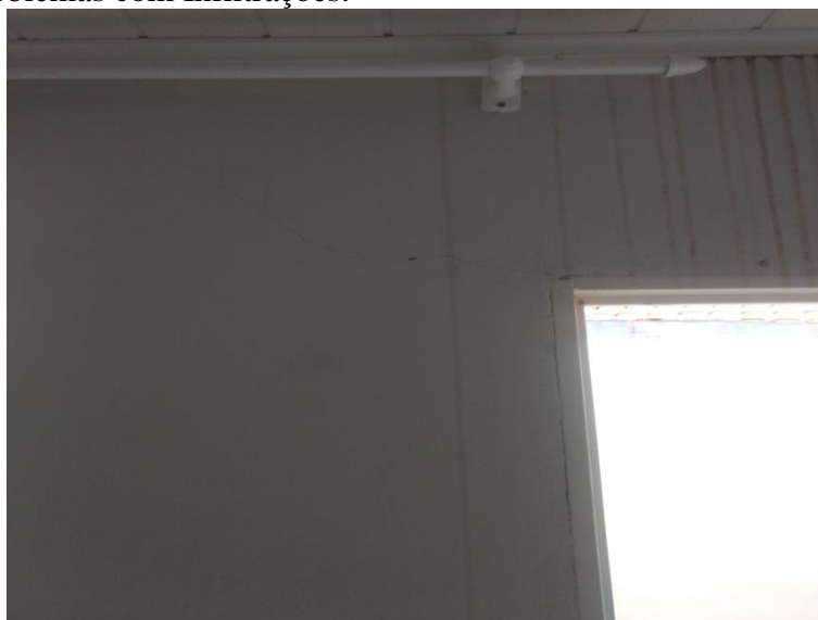
FIGURA 6 – Problemas com Infiltrações.
