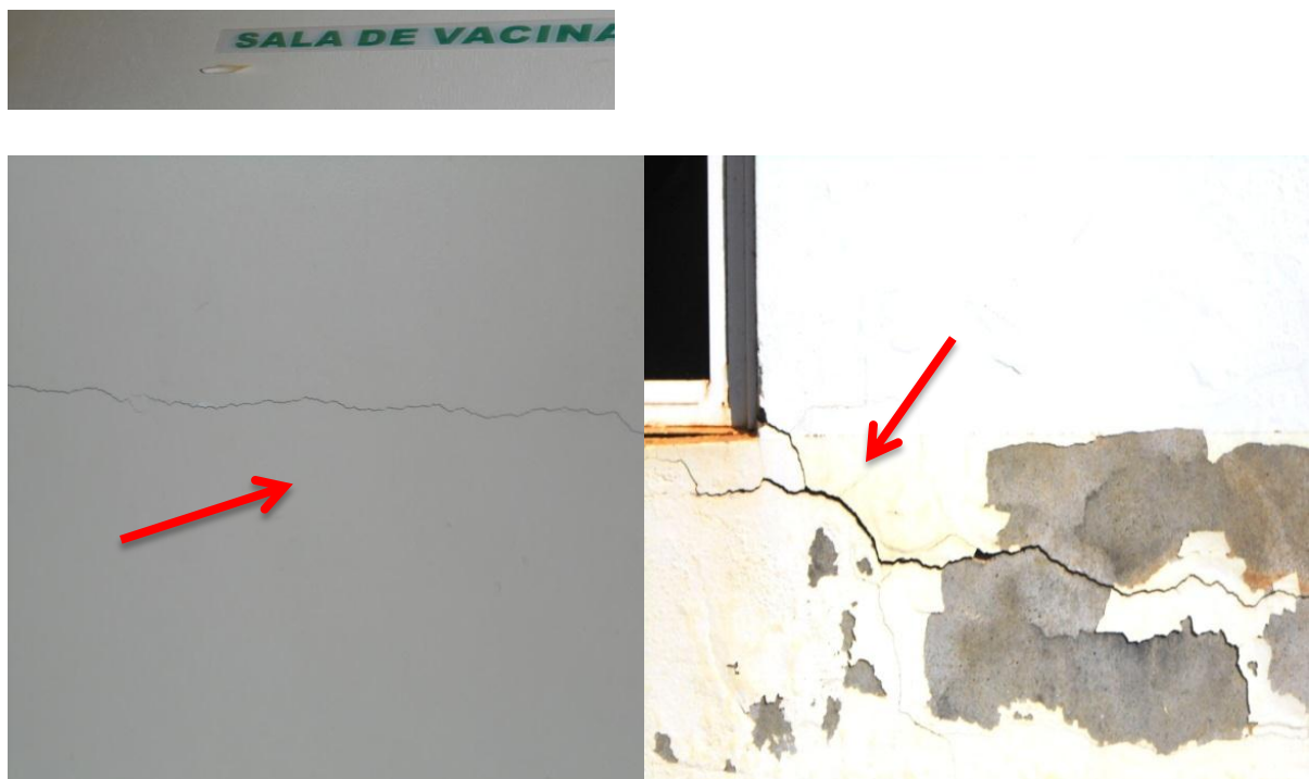
Fig. 4- Fissura horizontal causada por retração por secagem de lajes de concreto armado e devido a expansão do solo que gerou fissuras nas alvenarias, externas enfraquecidas por vãos das janelas.
