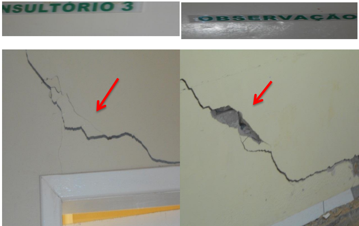
Fig. 3- Fissuras e Rachaduras inclinadas causadas por Recalque Diferencial nas Fundações.
