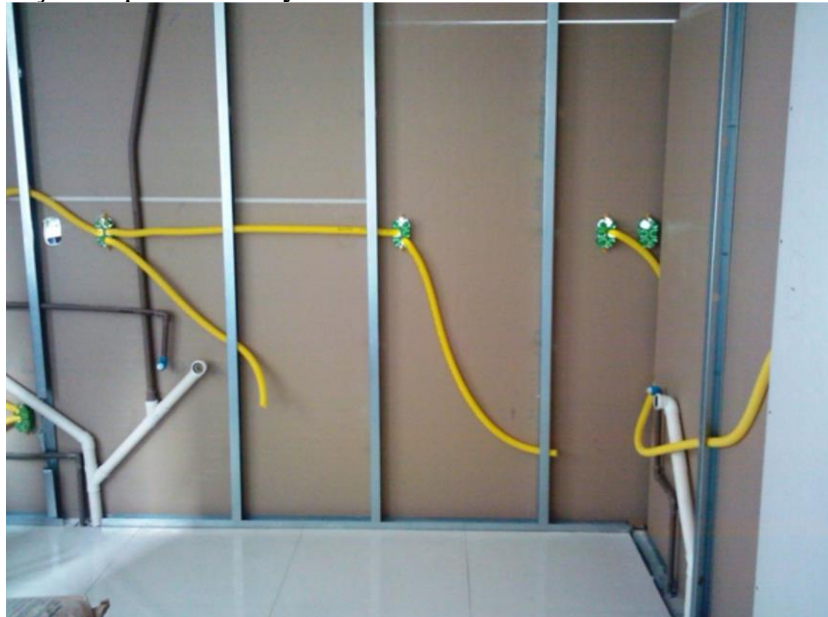
Figura 7- Tubulação de parede de drywall
